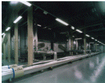
空調機械室 (14万㎡×24機)
